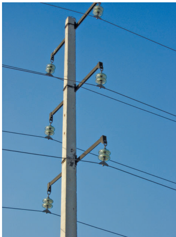
Рис. 3. ВЛ 10 кВ с подвесной изоляцией (Россия)
